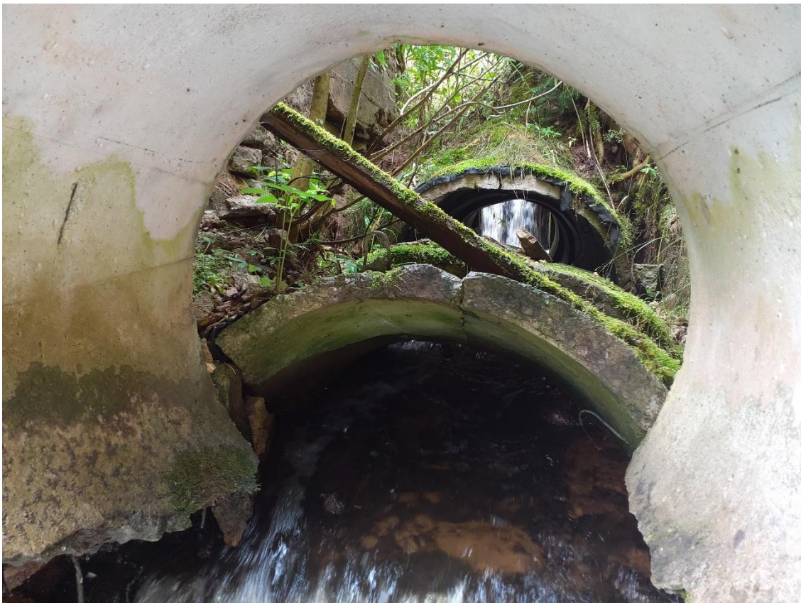
Joonis 6. Derivatsioonikanali lagunened truubid.
